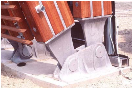
Figure 1: Liaison de pied d'arc (Nouméa, 1995)
