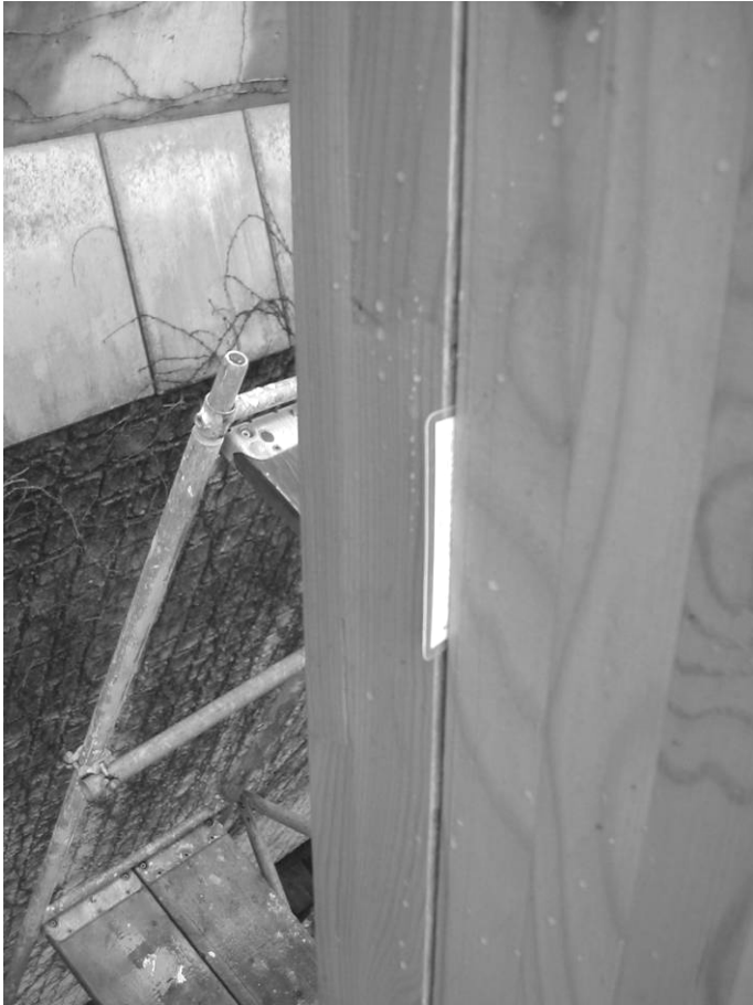
Abbildung 11: Delaminierendes Stück Brettschichtholz aus Lärche
