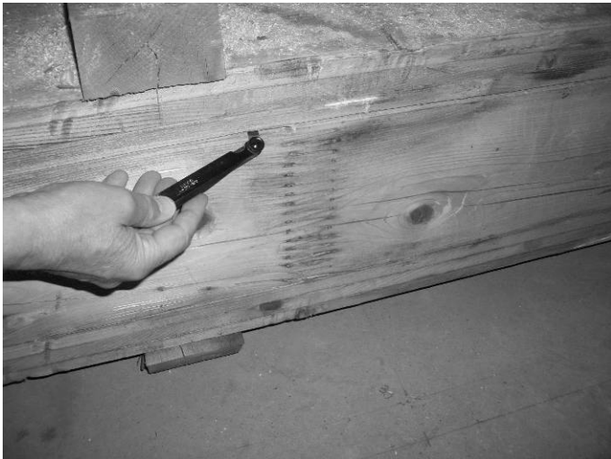
Abbildung 8: Geschädigte Fuge Steg-Gurt
