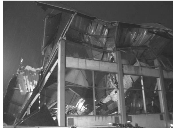
Abbildung 2: Teilansicht des eingestürzten Tragwerks
