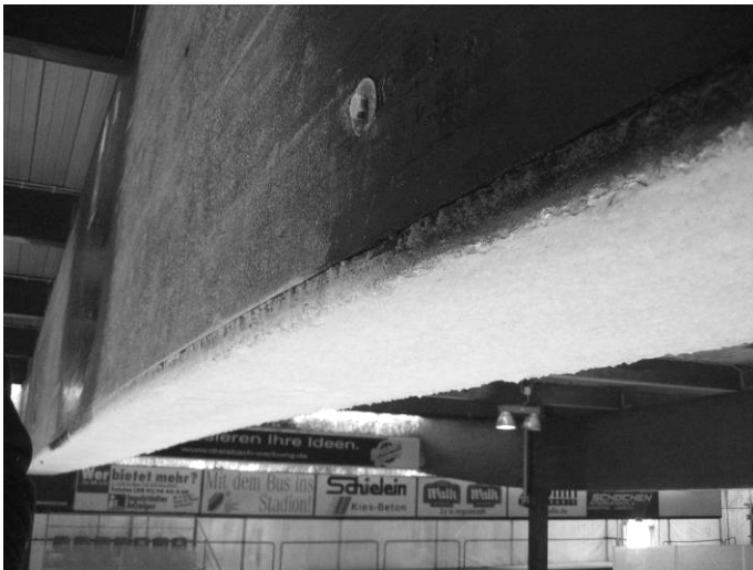
Abbildung 14: Eisbildung am Untergurt oberhalb der Eisfläche
