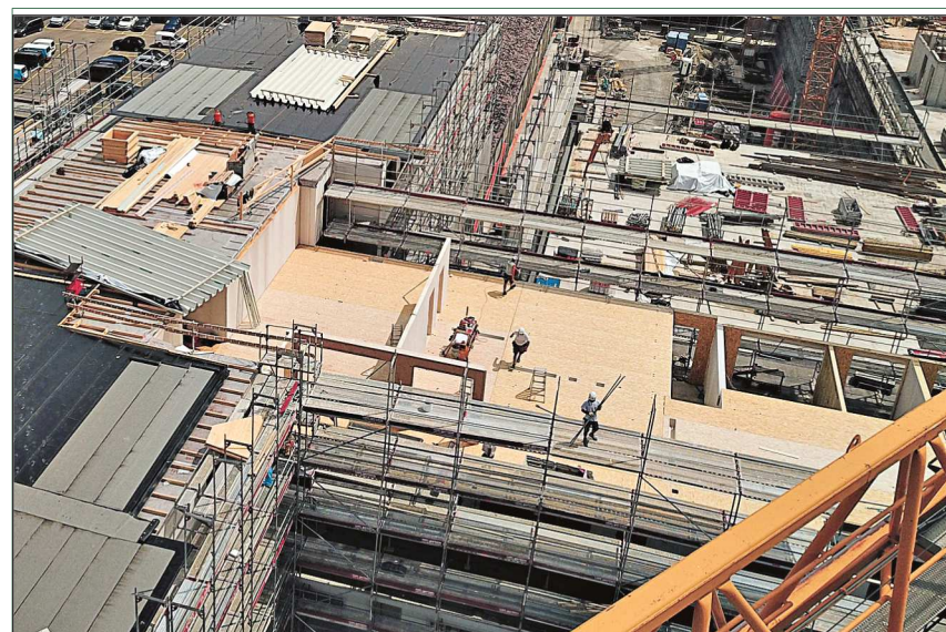
Auf den Bestandsbauten einer alten Kartonfabrik entstehen im Schweizerischen Bernapark derzeit im Zuge einer umfangreichen, zweigeschossigen Aufstockung 133 Wohnungen in Holzrahmenbauweise. Foto: Stuberholz
