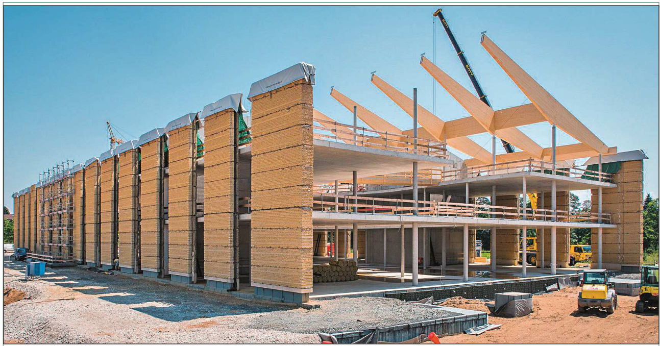
Der neue Campus der Firma Alnatura ist ein Beispiel für Lowtech im Bereich der technischen Gebäudeausstattung: Die Decken und Stützen aus Beton dienen als Wärmespeichermasse, die das Gebäude im Sommer vor Überhitzung schützen soll; zugleich wird der Energieaufwand für Heizen, Kühlen und Lüften minimiert. Foto: Alnatura
