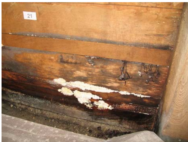
Abbildung 3: Pilzbefall aufgrund hoher Holzfeuchte
