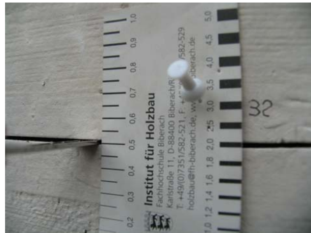
Abbildung 6: Riss in einem Brettschichtholzträger
