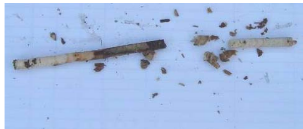
Abbildung 10: Bohrkern mit grossem Schadensumfang
