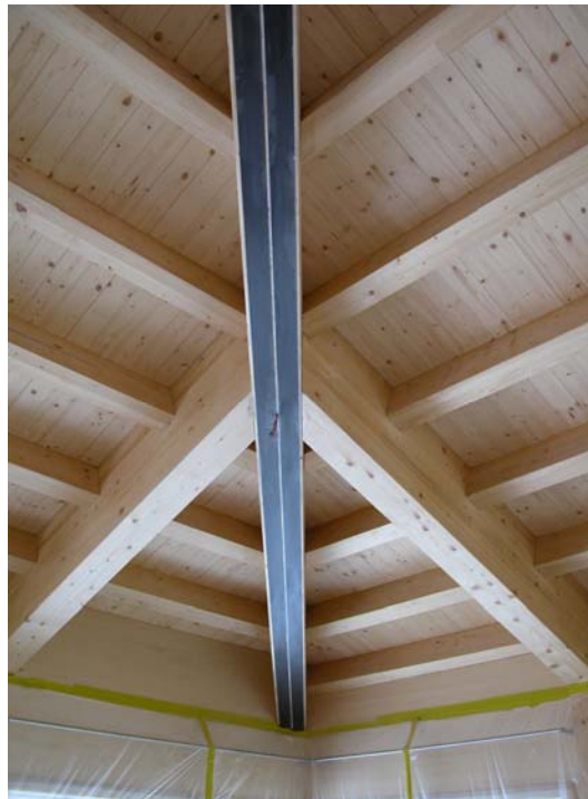
Bild 13: Gratsparren mit schlaff aufgeklebten kohlenstofffaserverstärkten Kunststoffen (CFK).
