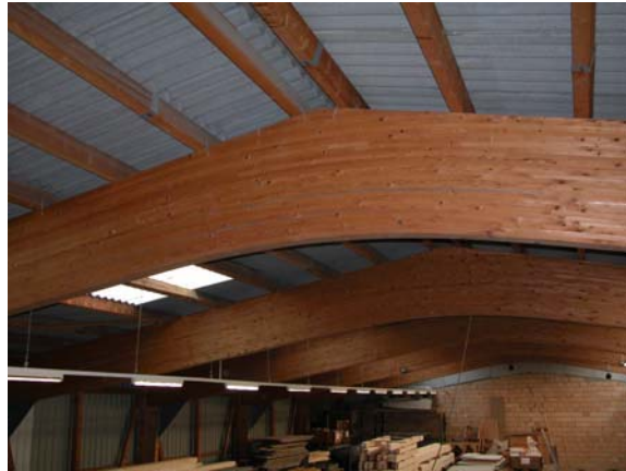
Bild 4: Satteldachbinder mit grossen Rissen im Bereich der Rundung unter dem First.
