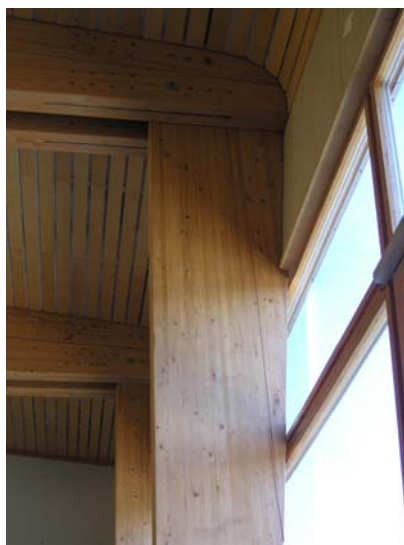
Bild 10: Stütze mit durchgehendem Riss.
