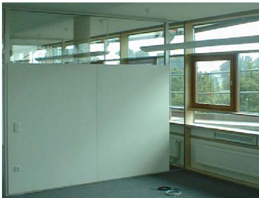
Fassadeninnenansicht mit Lüfter
