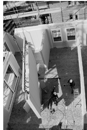
Die beiden Längswände und je zwei Innenwände (links) sind als tragende Wandscheiben ausgebildet.
