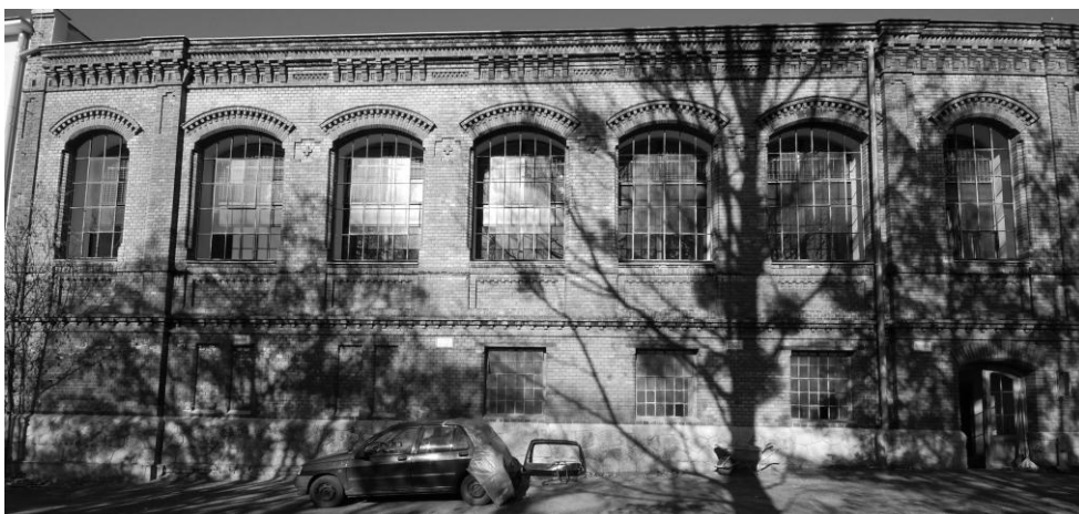
Abbildung 4: alte Fabrikhalle in Wien, denkmalgeschützt. Kann von außen nicht thermisch saniert werden. Der Heizwärmebedarf kann aus biogenen Brennstoffen geliefert werden. Bild: © by Fritz Klaura
