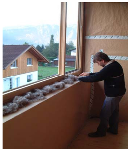
Abbildung 9: Passivhausfenster mit Schafwolle gestopft – kein PU-Schaum
