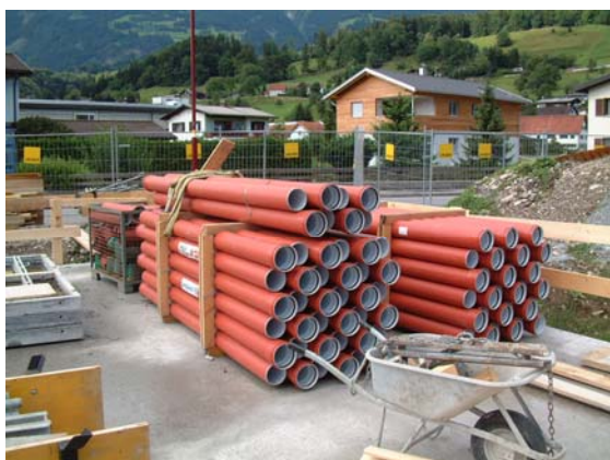
Abbildung 10: PVC freie Abwasserrohre
