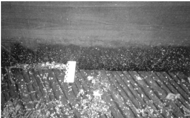
Abbildung 2: Spritzwasserbereich Brücke Münster (D)
