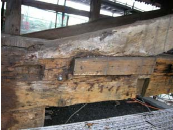
Abbildung 6: Strebenversatz vor der Sanierung
