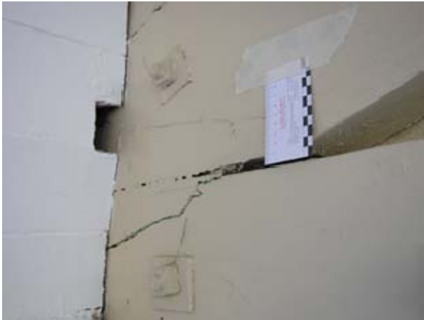
Abbildung 10: Schubbruch beim Auflager
