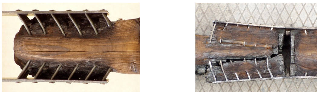
Abbildung 9: Rillennagelverbindungen mit aussen liegenden Blechen nach den Brandversuchen (links: Versuchskörper N1.1; rechts Versuchskörper N1.2).
