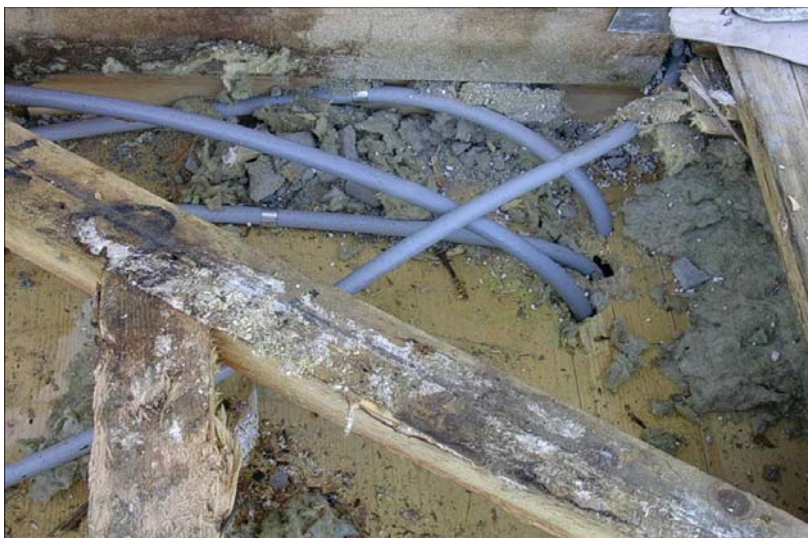
Abb. 3 Flachdach mit PE-Folie - Dampfkonzektion infolge Luftundichtigkeit bei Elektrorohrdurchdringung als einzige festgestellte Schadenursache
