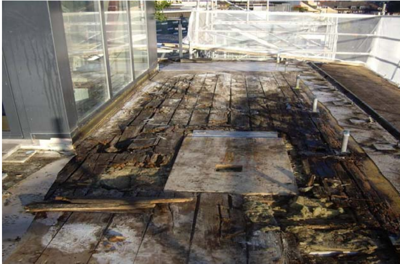
Abb. 2 Fäulnissschaden bei Flachdach mit PE-Folie als Dampfbremse, Baujahr 1998
