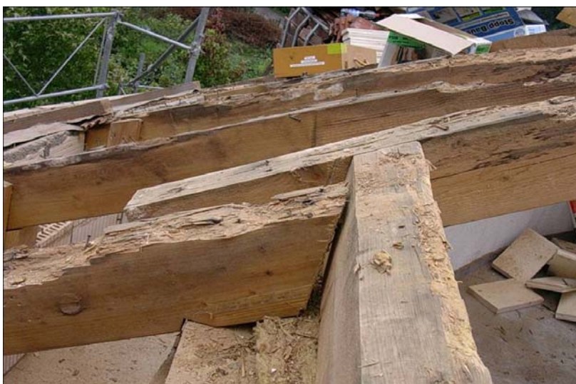
Abb. 4 Fäulnissschäden bei geneigter Dachkonstruktion mit mangelhafter Unterdachbahn (Diffusionswiderstand s = 20 m)
