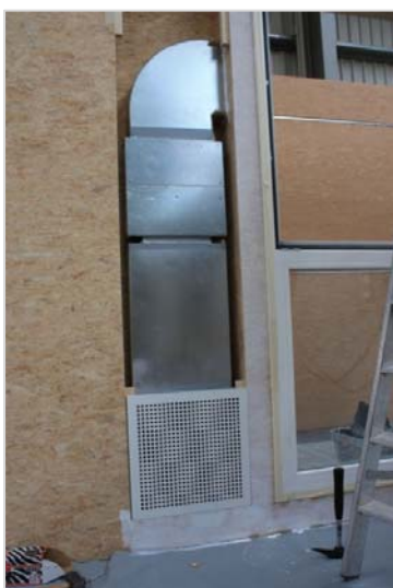
(Bild 20), Dezentrale Lüftung
