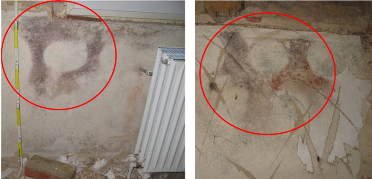
a. Undichtheiten an der inneren Holzfensterbank
