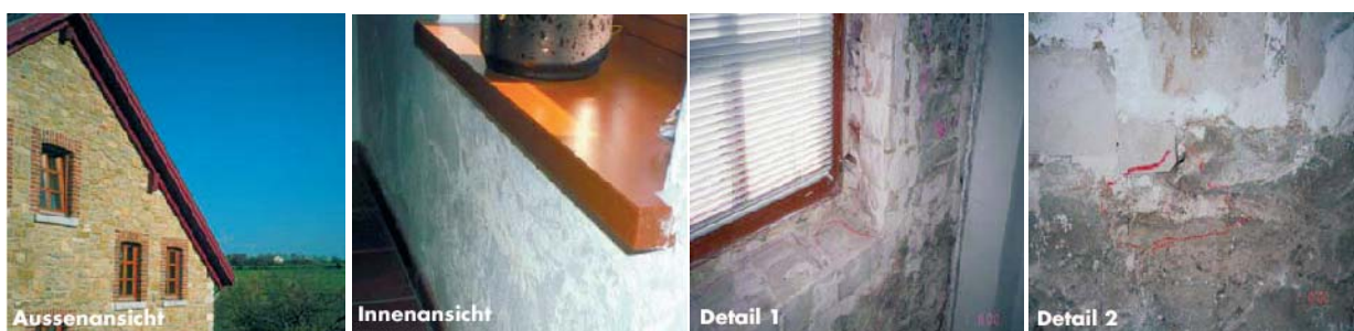
Abb. 4, a – d: Feuchteschaden bei innen gedämmtem Bruchsteinmauerwerk. Wetterseite bei hoher Schlagregenbeanspruchung. Fotos: Robert Borsch-Laaks
