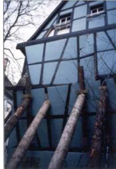
Bild 13: Instabilität einer tragenden Wand eines Riegelbaus in Colmar, F (Bild: Empa).
