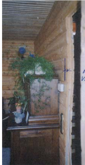
Bild 12: Seitliches Ausweichen einer Innenwand (Bild: [2]).
