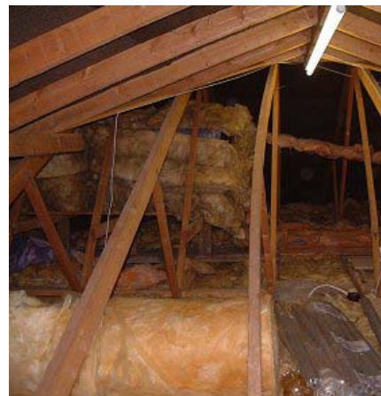
Bild 10: Dachverband mit zu geringer seitlicher Steifigkeit (Bild: Internet).
