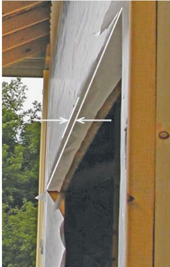
Bild 11: Seitliches Ausweichen einer Torwand (Bild: Internet).
