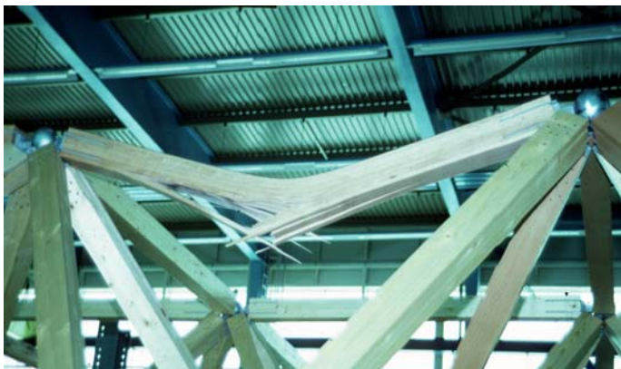
Bild 9: Knicken eines Druckstabes in einem Raumfachwerk anlässlich eines Belastungsversuches (Bild: ETH Zürich).
