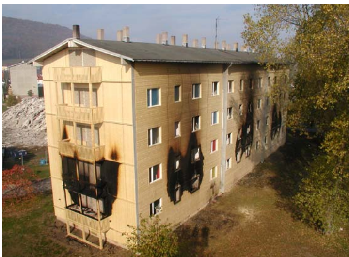
Abbildung 9: Schadensbild nach den Brandversuchen
