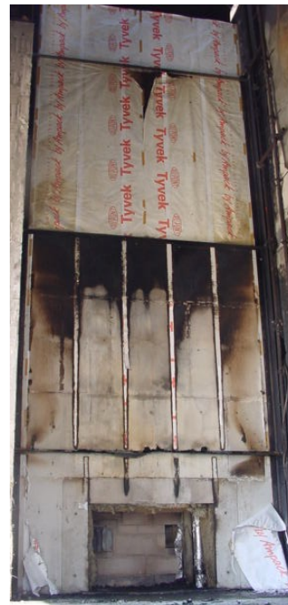
Schädigung Unterkonstruktion (20. Min.)
