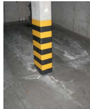
Streusalz (Chloride) dringt in Bodenplatte und Stützenfuß ein
