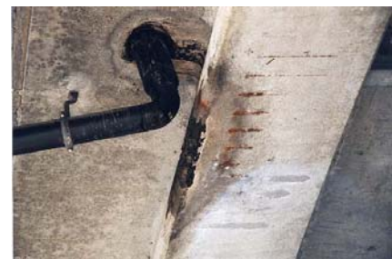
Abb. 3.2.1: Bewehrungskorrosion an Brückenuntersicht
