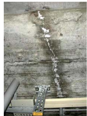
Abb. 2.5.1: Feuchter Riss an Decke
