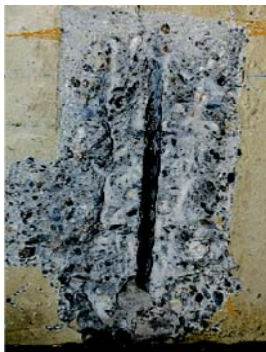
Bewehrungskorrosion (flächiger Angriff) im karbonatisierten Beton
