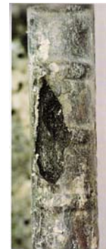
Lochfrass an Bewehrung infolge Chlorideinwirkung
