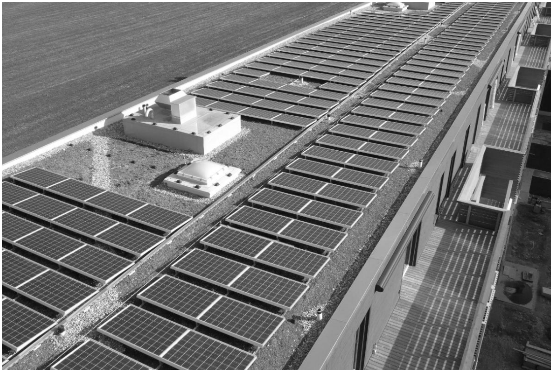
Abbildung 3: Photovoltaikanlage auf dem Dach
