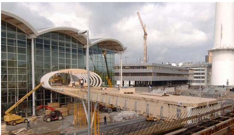
Abbildung 30: Alle Hauptteile sind montiert ( Die Fertigstellung der Erweiterung Halle 9, Ostseite, erfolgt Anfang 2006 )
