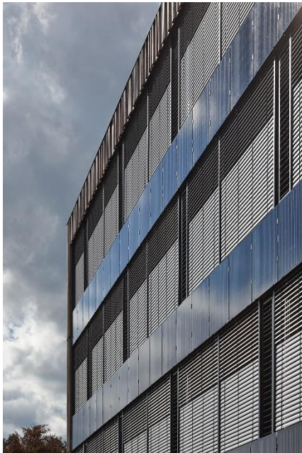
architekturintegrierte Photovoltaikanlagen der Südfassade
