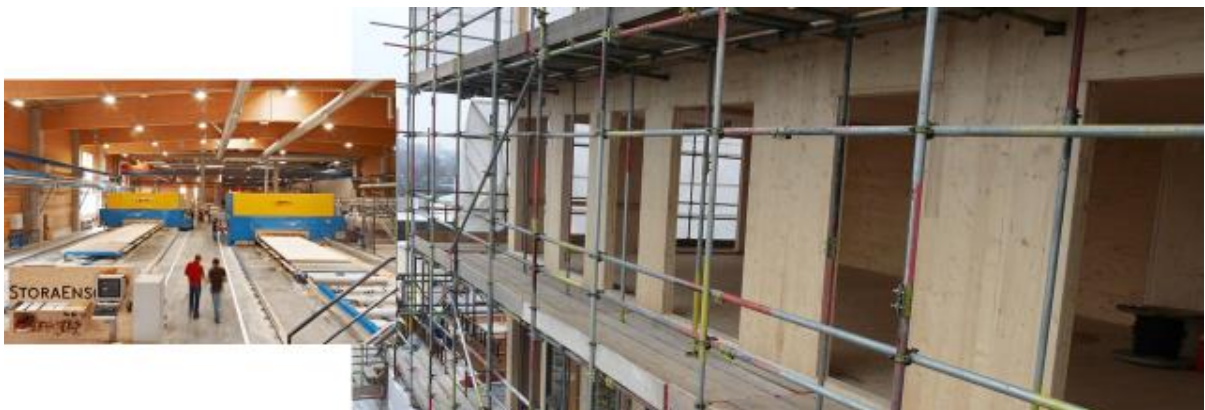
Abbildung 12: Brettsperrholzbauten werden in den meisten Fällen wie herkömmliche Ziegelsteinbauten auf der Baustelle montiert. Die Ausbauarbeiten mit Dämmungen, Dichtungen, Platten und Verkleidungen usw. erfolgen unter Baustellenbedingungen auf der Baustelle.
