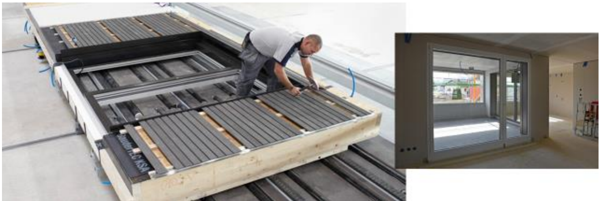
Abbildung 11: Die Skelett-/Rahmenbauweise erlaubt eine weitgehende Vorfertigung in den klimatisierten Hallen der Holzbauer und damit kurze Montage- und Ausbaueiten auf der Baustelle.
