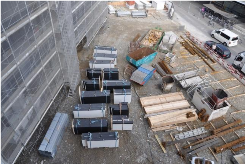
Abbildung 10: Paletten abgeladen und bereitstellt für das Anheben
