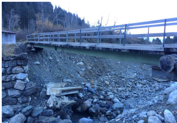
Abbildung 2: Zu ersetzendes Brückenprovisorium
