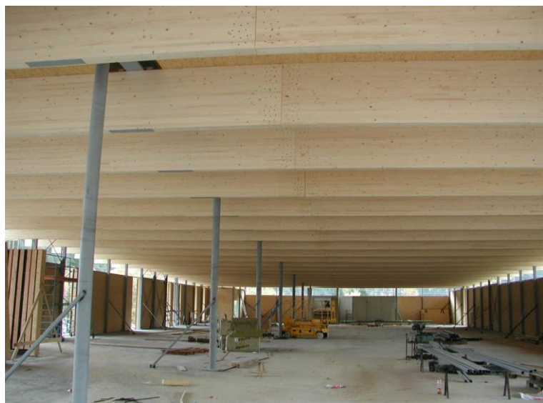
Abbildung 5: Die Dachträger mit Kopfplattenstößen, die Säulenmitteachse und die Fassadenstützen sind gut zu erkennen.
