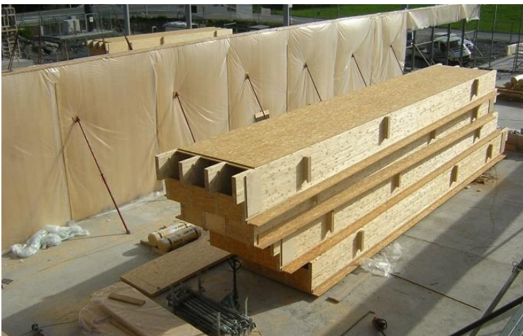
Abbildung 3: Die in Sicht bleibenden Brettsperrholzaussenwände sind mit Folie geschützt und für den Zusammenbau mit Schrägstützen gesichert. Die Holz-dachelemente liegen im inneren des Marktes und warten auf das Versetzen.
