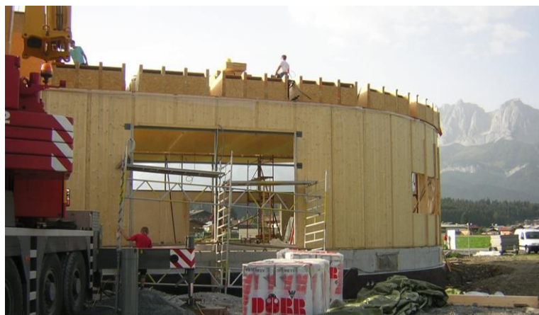
Abbildung 4: Aussenansicht, Brettsper Holzplattenstöße wurden mit Deckbrett ausgeführt, die Dachelemente liegen Mann an Mann, es fehlen noch die Fugenverschlüsse, die Querdurchlüftungsöffnungen sind gut zu erkennen.
