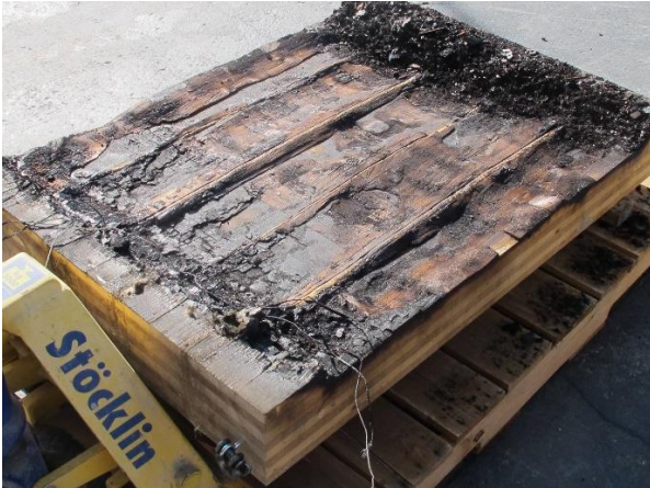
Abbildung 21: Kleinbrandversuche an Prüfkörpern aus Fichte CLT und Buchensperrholz nach dem Entfernen der Kohleschicht
