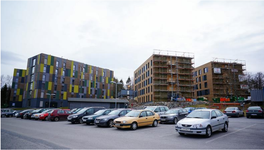
Abbildung 2: Zwei der Wohnheime in Halden (NOR) sind schon in Betrieb und zwei in der Endphase [Woodcon]
