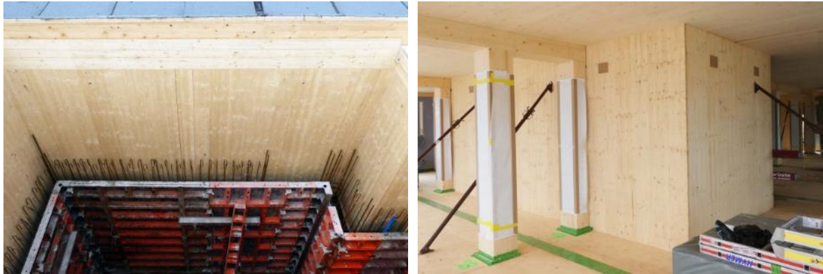
Abbildung 7: Die Dreischichtplatten sind gleichzeitig die Innenwand auf der Rauminnenseite und die (verlorene) Schalung für den Treppenhauskern aus Beton. Und: Die Treppenhauswand wird nicht dicker als in Massivbauweise. (Aufbau Monolithisch 25 cm, hier nur 20cm Beton 42 mm DSP, 15 mm Gips zum Abdecken der Bindelöcher).
