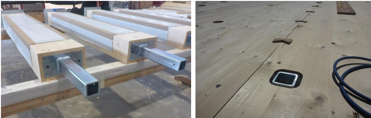
Abbildung 6: Dort wo die durchzuleitenden Lasten sehr gross sind und somit der Stützenszapfen im Unterzug einen zu grossen Ausschnitt bedingt hätte, erfolgt die Lastdurchleitung mit einem Stahlteil.
