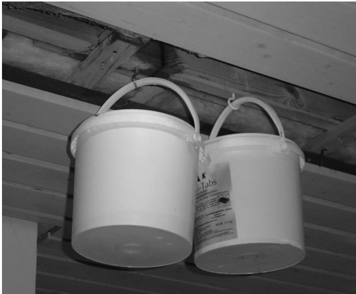
Abbildung 5: Wasser tropft aus der Flachdachkonstruktion
