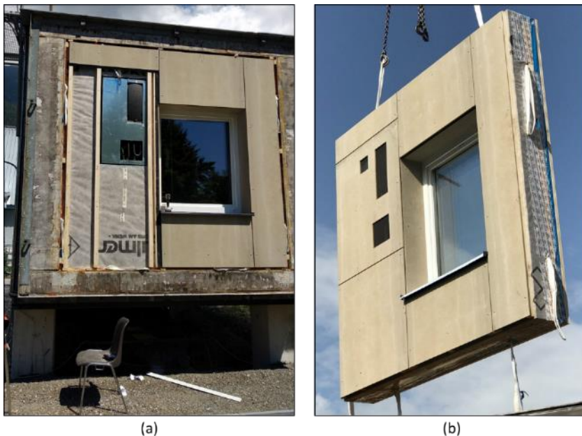
Abbildung 5: (a) Funktionsmuster einer vorgefertigten Holzfassade mit integrierter Außeneinheit der Heizungs-Lüftungswärmepumpe in der PASSYS Testzelle der UIBK und (b) während der Installation des Fassadenelements (Holzbau Kulmer)
