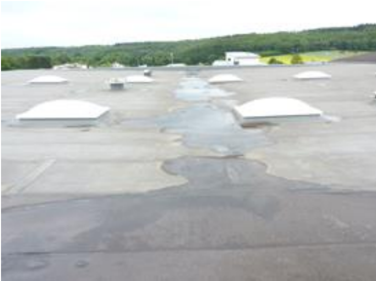
Bild: Pfützen in Kehlen und bei Gefällewechsel
