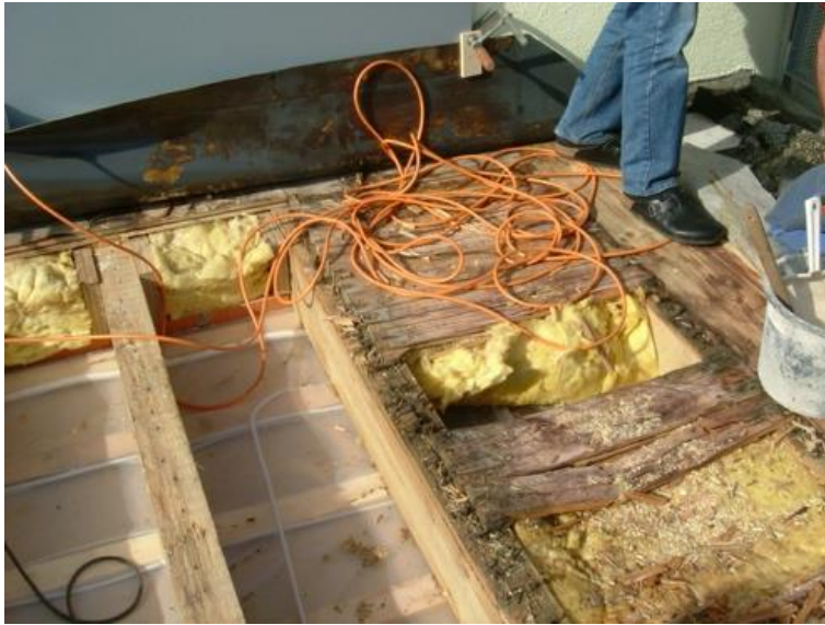
Bild: Schadensfall Flachdach in Holzbauweise; Quelle: Adamek
