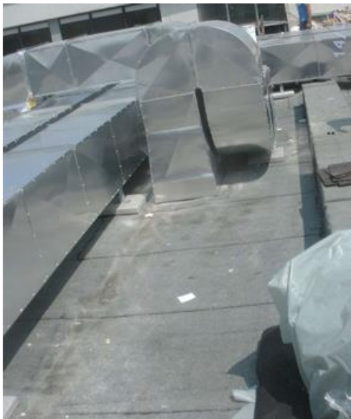
Bild: mangelnde Wartungswege und Abstand der Anlagetechnik zur Abdichtung; Quelle: Hensler
