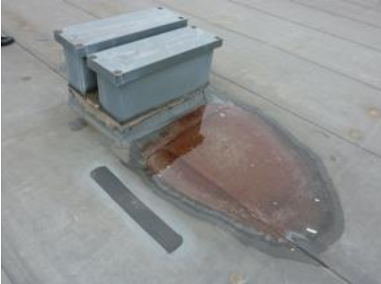
Bild: mangelnder Gefällewechsel hinter Durchdringungen
