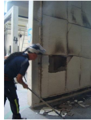
Abbildung 20: Öffnung der Beplankung - 6 Minuten nach Prüfe - WA1
