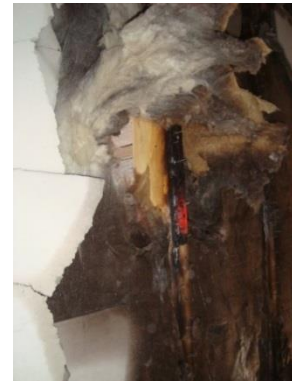
Abbildung 23: WA1 - fortschreitende Verkohlung bei einzelnen Stehern im Bereich Plattenstoß - 34 Minuten nach Prüfe
