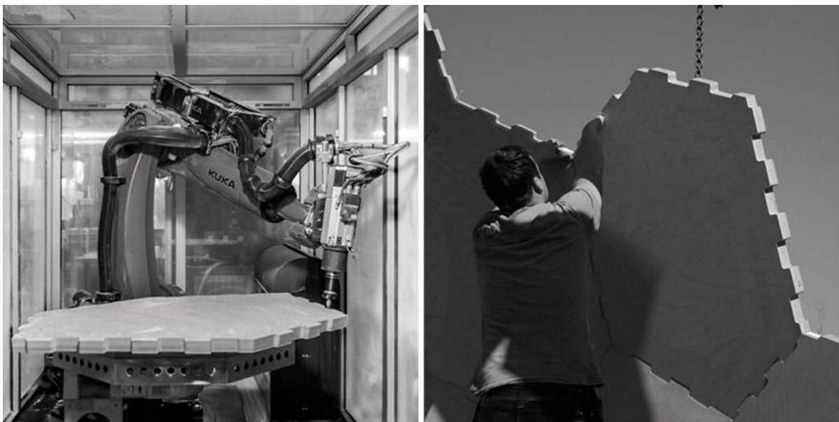
Abbildung 5: Das weiterentwickelte Konstruktionssystem aus Buchensperrholz wird auf einer robotischen Anlage gefertigt (links). Die Montage vor Ort (rechts) auf der Landesgartenschau Schwäbisch Gmünd benötigte drei Wochen.
