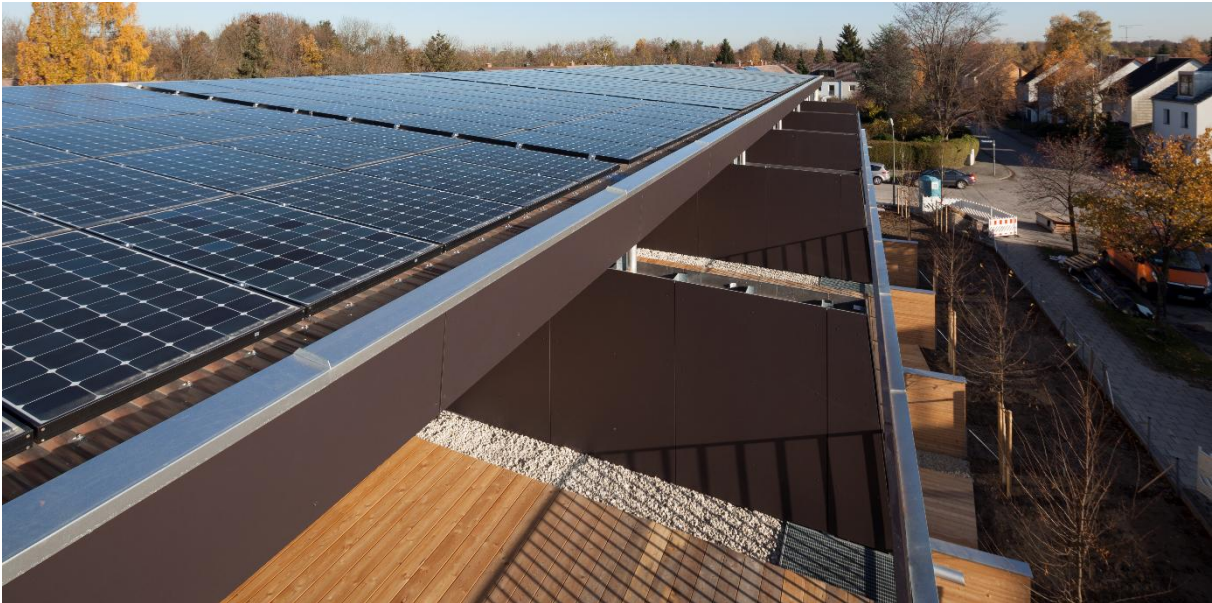
Abbildung 2: Einbindung der PV _ Passivhaus-PLUS Wohnanlage in München- Obermerzing (Foto Südhaubau)
