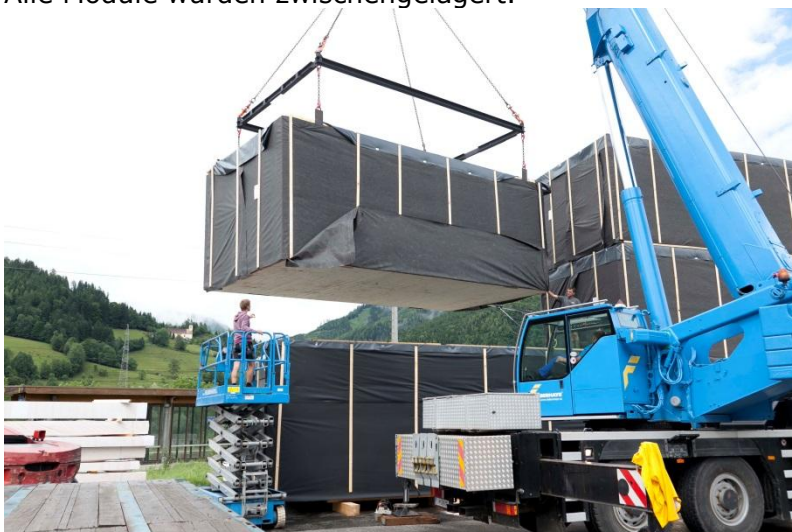
Abbildung 16: Lagerung der Module
